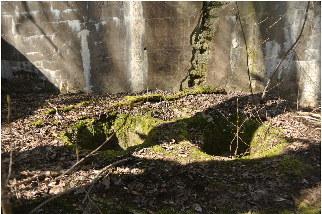
Illustratsioon 17. Aukudega betoonplaat
