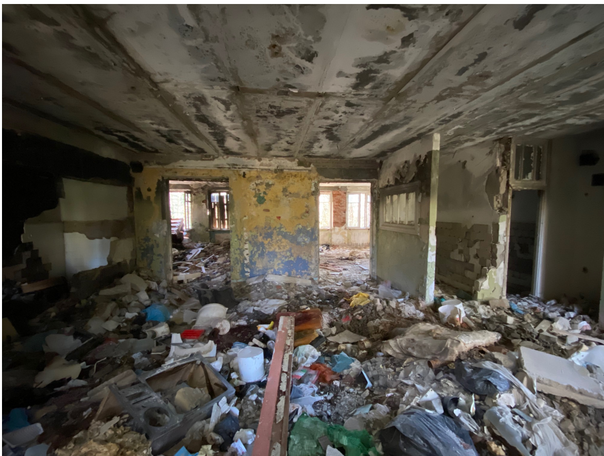
Joonis 90 Hoone on seest lõhutatud ja reostatud.
