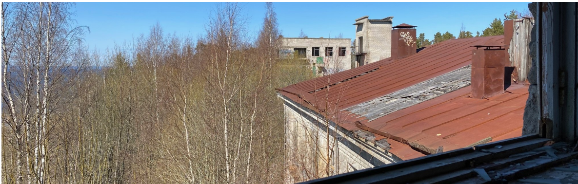
Joonis 25 Vaatlustornist on näha, et vana hooneosa plekk-katus on katki.
