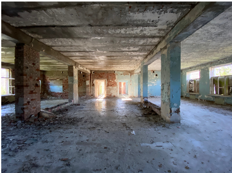
Joonis 56 Sööklaruumi laed tilguvad läbi. Põrand on plaaditud.
