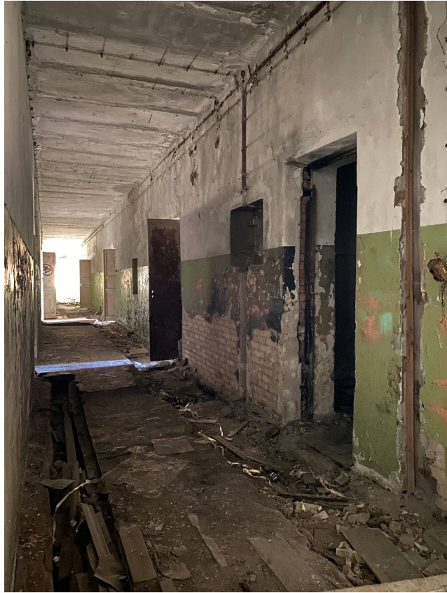
Joonis 24 Põrandad ja siseuksed on lõhutud. Näha on kanalid, milles on paiknenud kommunikatsioonid.
