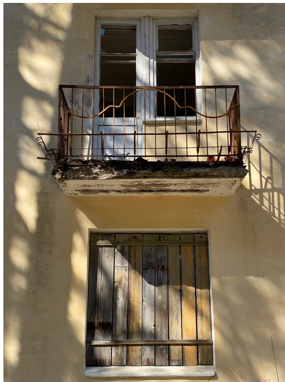
Joonis 42 Rõdude põrandad lagunevad.
