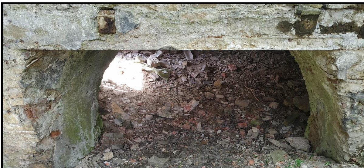
Foto 17 // Vaade eesruumist lääne tiivale, kus on ristvõlvkeldris. Sissepääsu kohal on metalltala kui ka puittala otsad. Autori foto, 2021 a.
