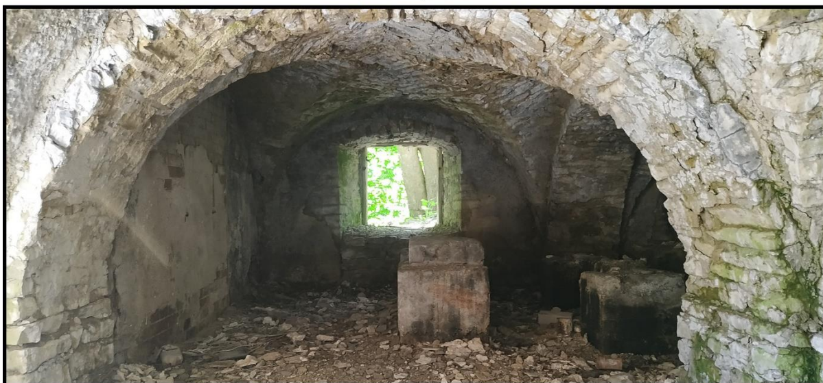
Foto 18 // Vaade Lihula ristvõlvkeldris. Paremäl on märgata "sokli" ladumist. Vasakule jääb parasiitosa nr. 1. Võimalik õlleköögi osa. Autori foto, 2021 a.
