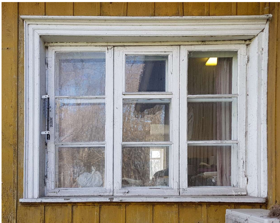
Foto 38 | Hoone ainus kolme raami ja 9 jaotusega aken. Väljast vaadates on akna seisukord hea, kuid siseruumis on lagedes ja seintel näha veekahjustusi, mis on ka akna lengide ja piirdeliistude taga kogunenud. Enne avatäitega tegemist tuleb kontrollida silluse seisund.
