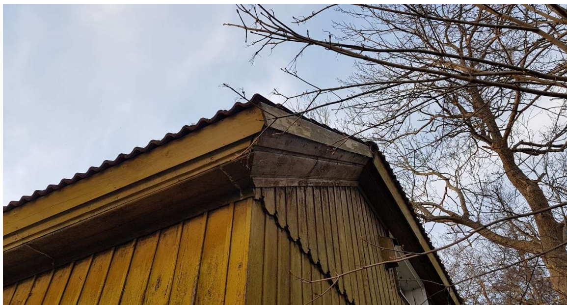
Foto 18 | Näide puitkarniisist ja räästalaudade lohakast paigaldusviisist. Hoonel ei ole ajalooliselt olnud vihmaveetorusid. Vihmaveesüsteemi rajamist tuleks aga tõsiselt kaaluda, kuna vesi langeb ühtlase joana hoone seinast ca 40cm kaugusele, pritsib soklikrohvide ja hiljem imbub pinnasesse vundamendi vahetus läheduses.
