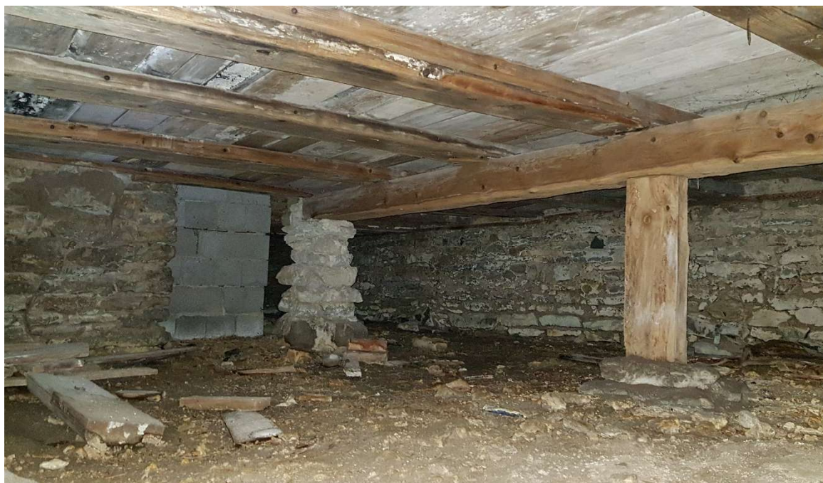
Foto 6 | Vana hoonemahu põrandatalad, läänepoolse korstna vundament. Põrandatalasid kandev puittala, toetatud peakivivundamendile ja puitpostile paekivi taldmikul.
