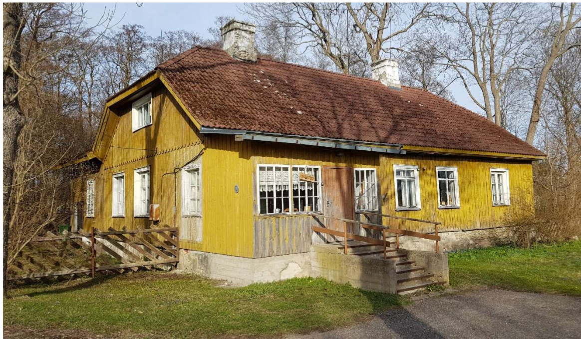
Foto 15 | Hoone loodenurk. Esiplaanil nähtav ümberehitatud veranda, mille ehitusaegne paiknemine on seinal loetav värvipinnalt, katusekallet imiteerivad fassaadil jooksvad elektrikaablid. Fassaadivärvi mahakulumine on olnud ebaühtlane, veelaua kohal ei ole enam kaitsekihist midagi säilinud ja väärtusliku laudise otsad on „närtud“ ja pudedad.
