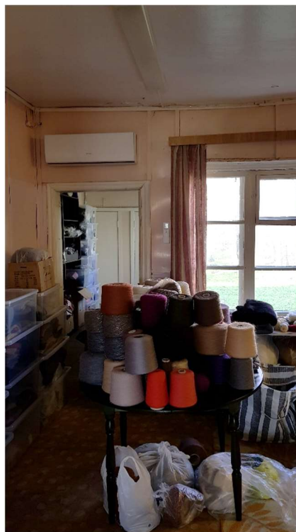
Foto 43 | Veekahjustusega lokkiv soomepapp seinas, Lahtilõõnud krohv lae nurgas. Akna sillus vajab kontrollimist.
