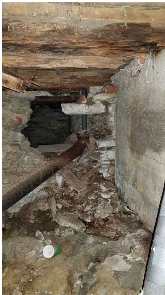
Foto 8 | Läänefassaadi vundament, juurdeehitusega liitumise kohas, kanalisatsioonitoru läbiviigu ümbruses on paekivivundament edasi lagunenenud. Kuna tegu on nurgaga ja sildav palk võib olla sarnaselt naaberladega amortiseerunud, tuleks vundamendi nurk taastada. Vajadusel lahendada ringi kommunikatsioonide kulgemine vastavalt tänasele vajadusele. Lisaks on esiplaanil näha avariiline tala juurdeehituse osas.
