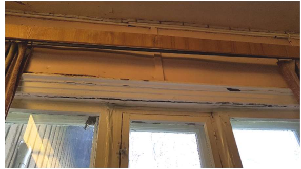
Foto 11 | Akna toapoolsed piirdeliistud on lahti paistetunud. Neelu läbijooksust kahjustunud seinasildade vajumine või lengi väändumine. Enne avatäite restaureerimist on vaja sildava palgi tehniline seisukord kontrollida.
