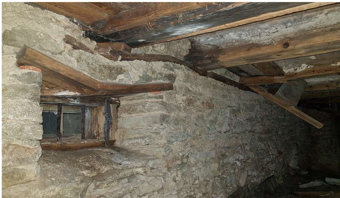
Foto 5 | Vana hoonemahu vundamendis olnud puiduga sillatud ava. Põrandatala alla on arvatavasti loodimiseks pandud kiilud. Kahe esimese tala otsad tumenenud, aluslaudist kandvad talale kinnitatud prussid alla kukkunud ja aluslaudis koos isolatsioonikihiga vedeleb vundamendiaugu muldpõrandal.
