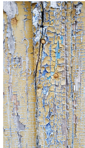
Foto 14 | Välisviimistlus „krokodilli nahk“ mis on avanud veranda konstruktsiooni lammutamisel. Ülejäänud värv on pigem tolmjalt pinnal.
