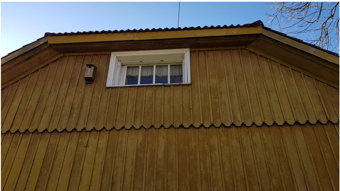
Hoone Idafassaad. Hästi vaadeldavad puitkarniisid ja räästas tehtud asendus. Viiluvälja lihtne puitpits. Linnupesakastid hoonete otsaviiludes on Kärldale iseloomulik ja väärrib elemendina säilitamist. Vaadeldav värvikihi ebauhtlane kulumine. Koopiaga asendamisele kavandatud põõninguaken.
