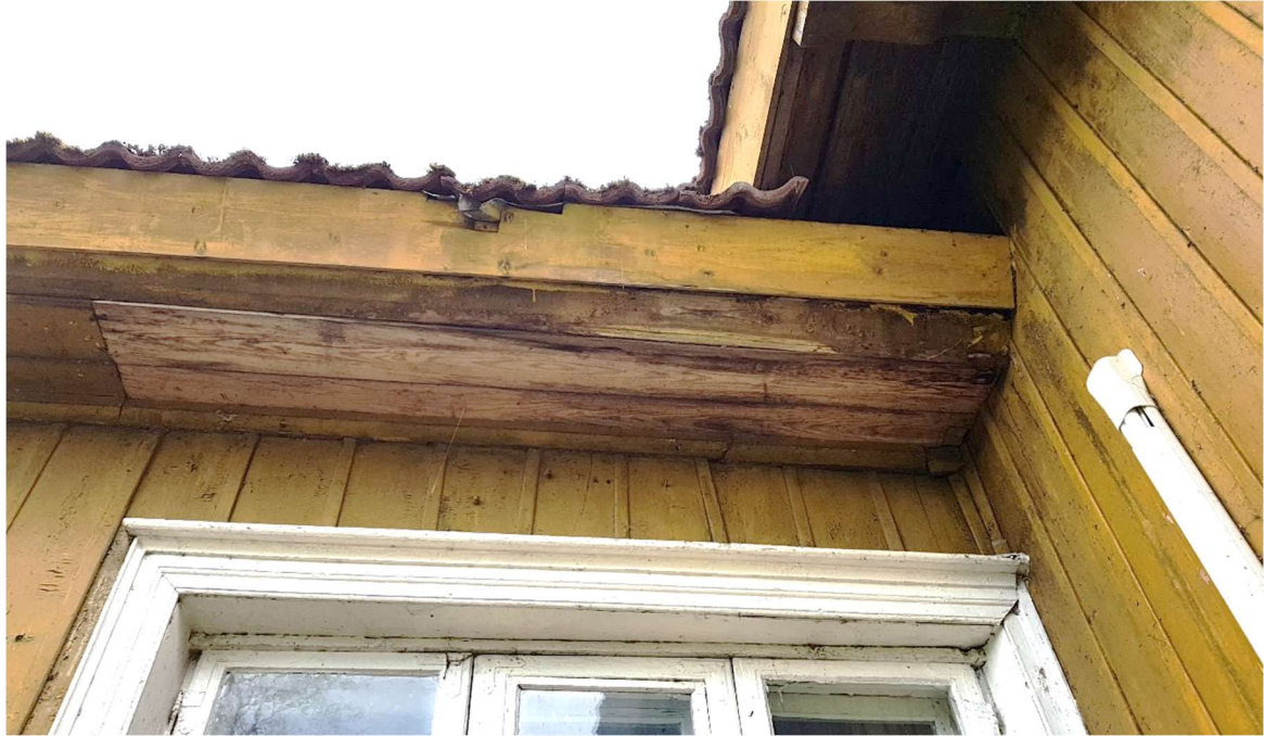
Foto 17 | Hoone põhjakülje sisenurga paigutatud räästas. Lisatõendid pikaajalisest vee läbijooksust, mis katuse rekonstrueerimisega on parandatud. Plommimine on tehtud algse räästa profiili eirates, ehissuont ei ole taastatud.
