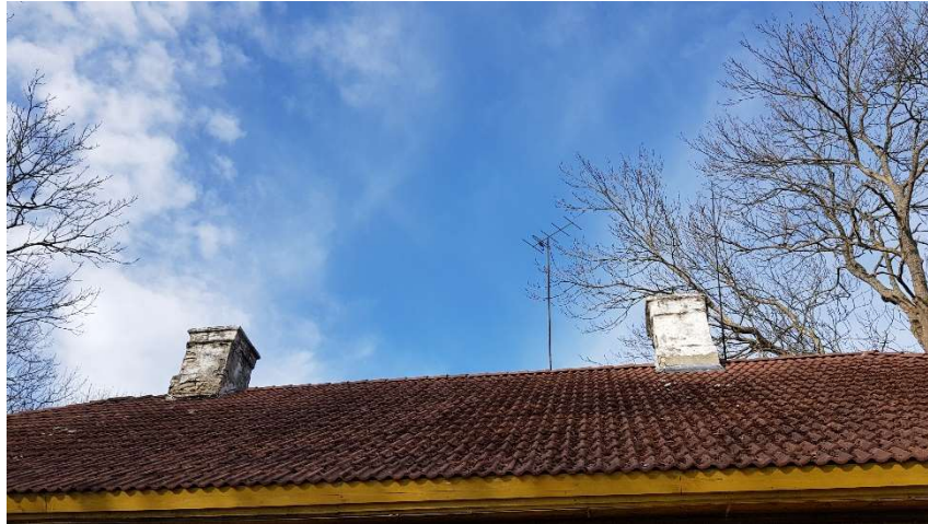
Foto 23 | Hoonel on kaks korstent. Säilinud algsed paekivist kolme veekiviga korstnad on väärtuslikud elemendid ja tuleb hooldada ja taastada vastavalt.
