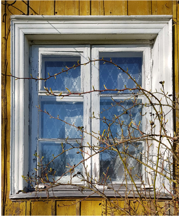
Foto 26 | Algpärane aken, kahehaamiline kuue jaotusega. Tuulutusaken üleval vasakul. Veeninad on ilmastikust tugevalt kahjustunud, puidu hävinemisel on lahti tulnud metallist aknanurgikud. Veelaul kaitse puudub, on paisunud ja keskelt üles paindunud ca 2cm.
