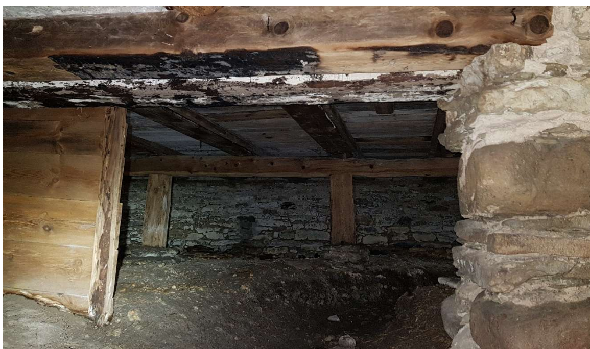
Foto 7 | Vana hoonemahu keskel olev siseseina alumine vundament. Keskelt sillatud talaga, nagu paljudes muudes kohtades on puidu värvi muutunud, pole kindel kas tegu on hallituse, seene, mädanikuga. Valgeks värvunud kohad olid vaadeldud kohtades pigem niiskunud lubjastest liivast välja immitsenud vee ladestumine pinnal. Samas ei ole tagatud piisav tuulutus ja näha on kahjustunud puitpindasid, talade seisund vajab põhjalikku kontrollimist. Puidust vaheseina alumine serv on kahjustunud. Sellsied ebavajalikud puitdetailid tuleks pinnalt eemaldada.
