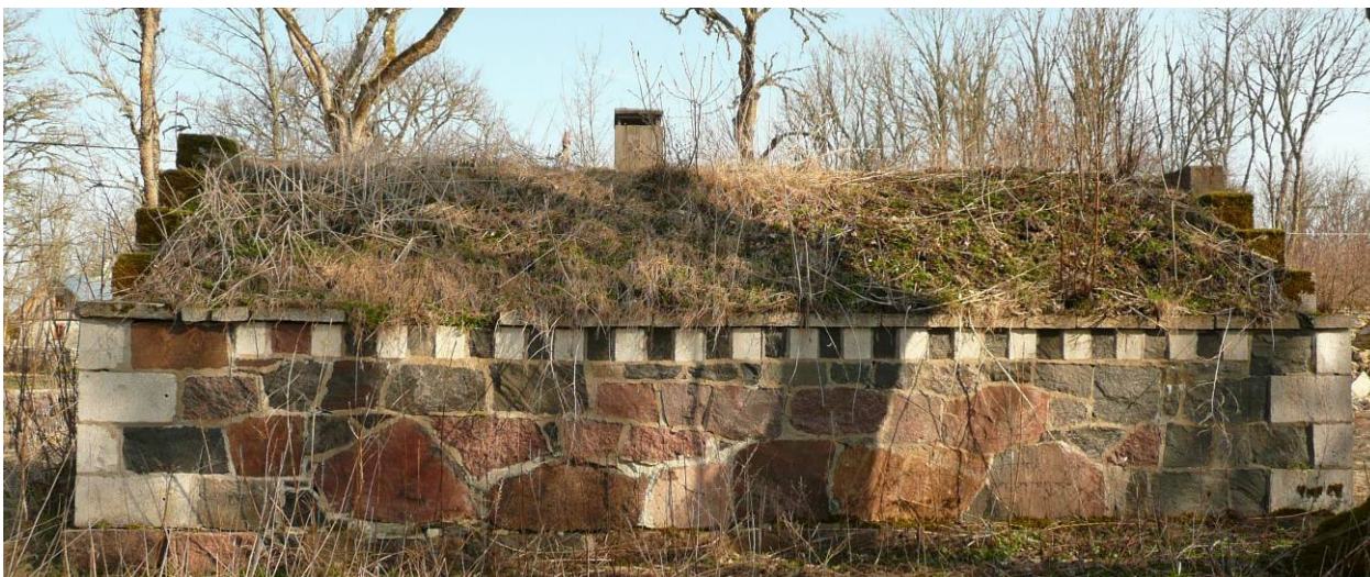
Foto 102. Korstnaümbruse katusekate vajab täiendavat tihendamist ja isoleerimist.
