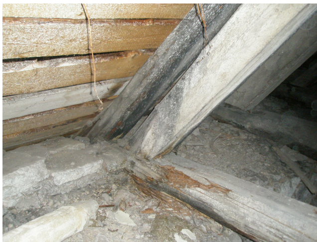
Pilt 35. Niiskusest kahjustunud puitkonstruktsioonid . Allikas: Tatjana Hünne, aprill 2012.
