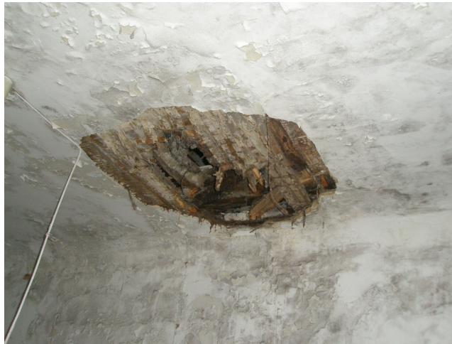
Pilt 30. Vahelagi on kohati pehkinud sadevete läbijooksu tagajärjel. Allikas: Tatjana Hünne, aprill 2012.
