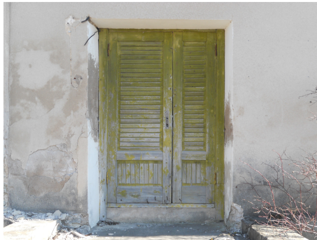
Pilt 33. Nõukogude ajal on akna asemele tehtud ukseava. Uks on rahuldavas seisukorras, kuid vajab hooldusremonti. Allikas: Tatjana Hünne, aprill 2012.
