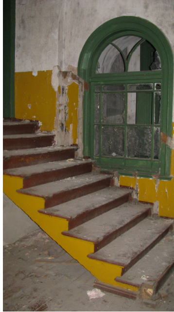
Pilt 39. Interjöõri detailidest on säilinud ja kuulub restaureerimisele puittrepp kahe korruse vahel. Allikas: Tatjana Hünne, aprill 2012.
