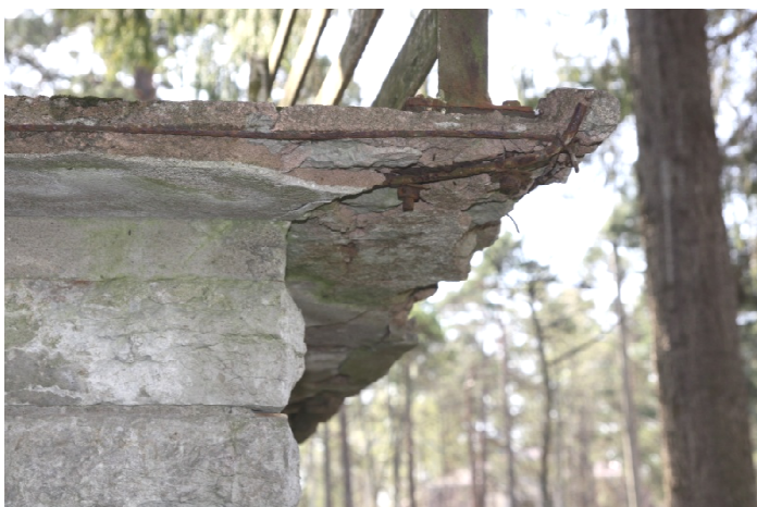
Foto 7, Ühekordse hooneosa terrassipõrandast alt vaade
