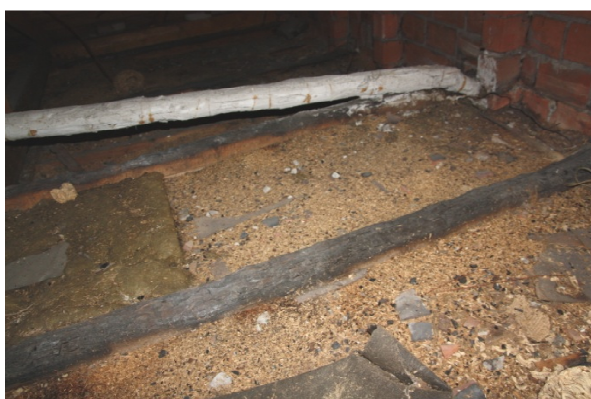
Foto 10, laetalastik tulekahju kahjustustega
