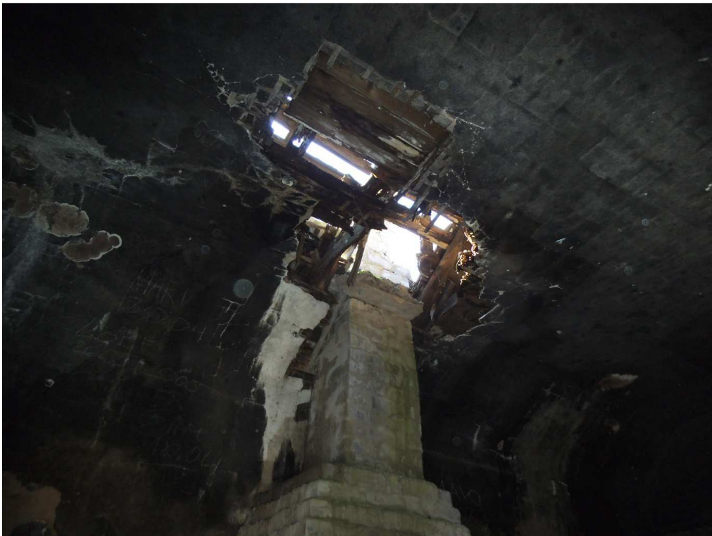
Foto 36. Katuse läbijooksust põhjustatud lae kahjustused
