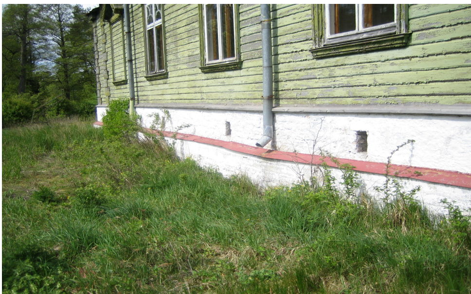
Foto 2. Vajunud vundament lõunaküljel.
