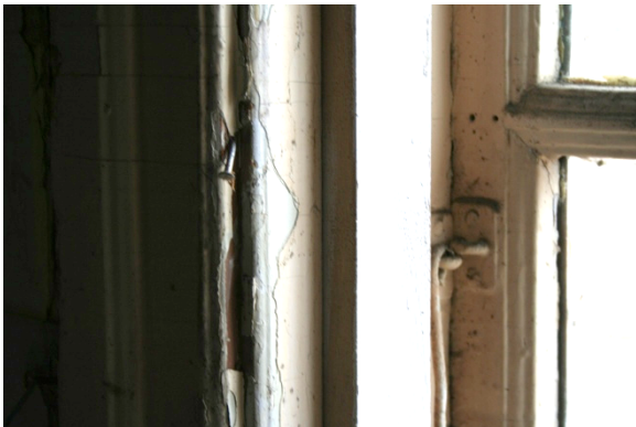
Foto nr. 52. Aken A5 seest – välimine profileeritud raam, puuduv siseraam, hilisem lisatud siseraam ning sisemise piirdeliistu fragment.
