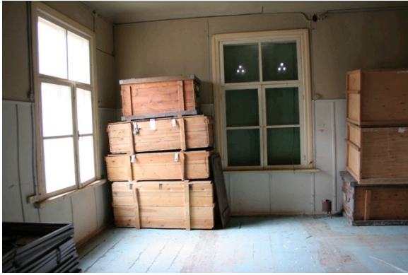
Foto nr. 56. Aknad A1 ja A2 ruumis nr.5; vineertahvlitega kaetud seinad.
