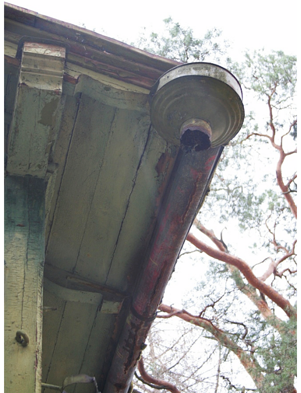
Foto nr. 25. Räästaalune, vihmavee lehter (edela nurk).
