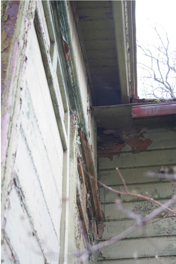
Foto nr. 30. Veranda parempoolne sisenuk, kahjustus katuse räästa all.
