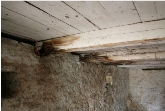
Foto nr. 11. Veranda põrandalaagide otsad verandaaluses ruumis.
