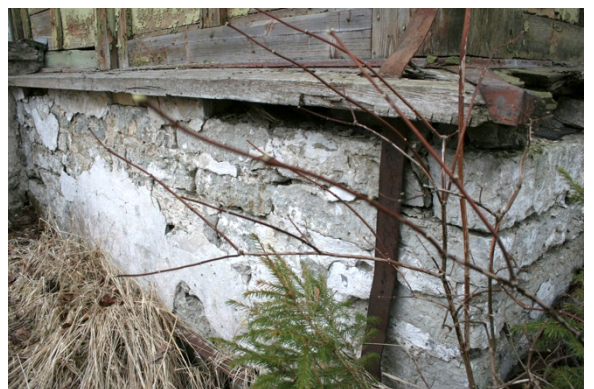
Foto nr. 9. Veranda parempoolne välisnurk. Veelaua seisukord.
