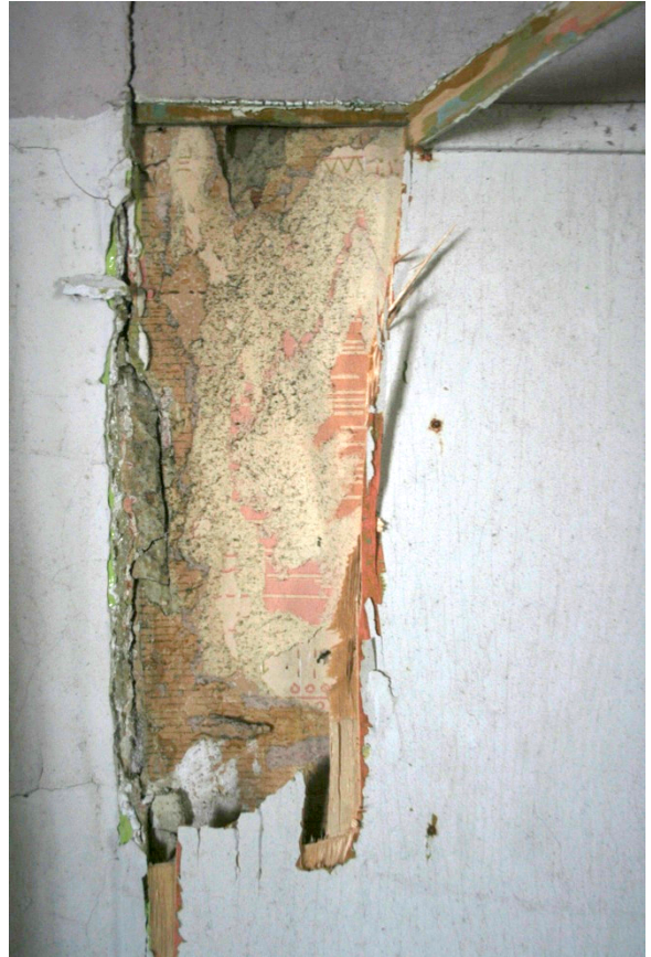
Foto nr. 59. Avatud seiniosa ruumis nr.6. Ahjust paremal vineeri all näha tapeedikihid. Avamine kõrgusel ca 1400mm.
