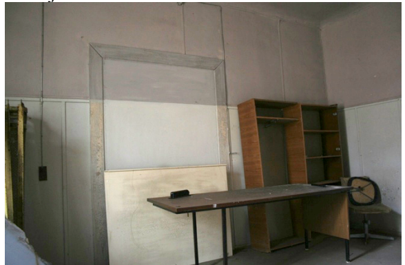
Foto nr. 54. Aken A4 – vaade kinniehitatud aknale seest poolt (ruum nr.6); pildil ka vineertahvlitega kaetud seinad.
