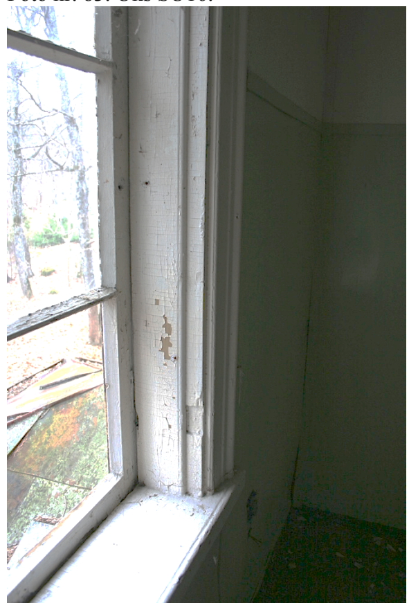
Foto nr. 84. Aken A17 seest poolt. Puuduv siseraam.
