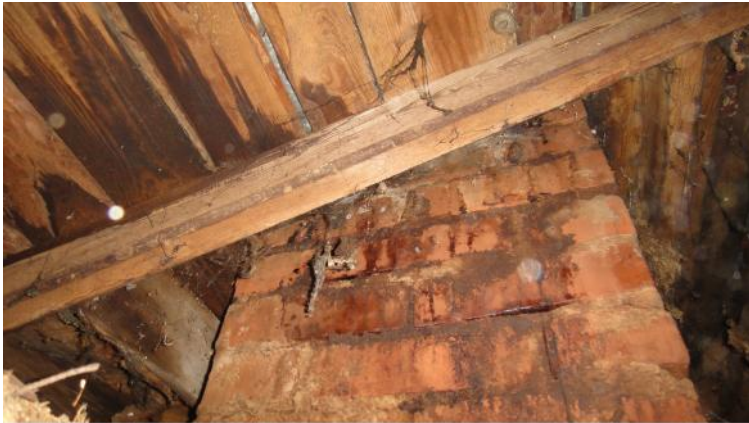
Foto 18. Niiskuskahjustus korstna juures
