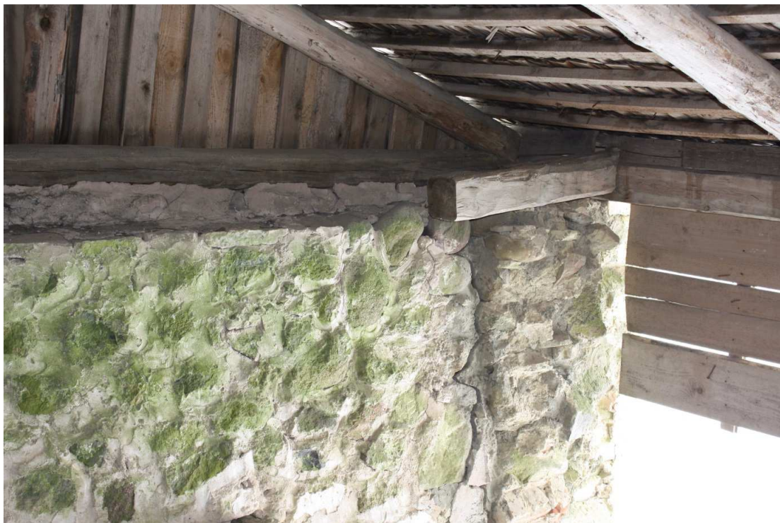
Foto 5 ja 6 . Müüritise ja nurgapilastri vaheline prao kulgemine.
