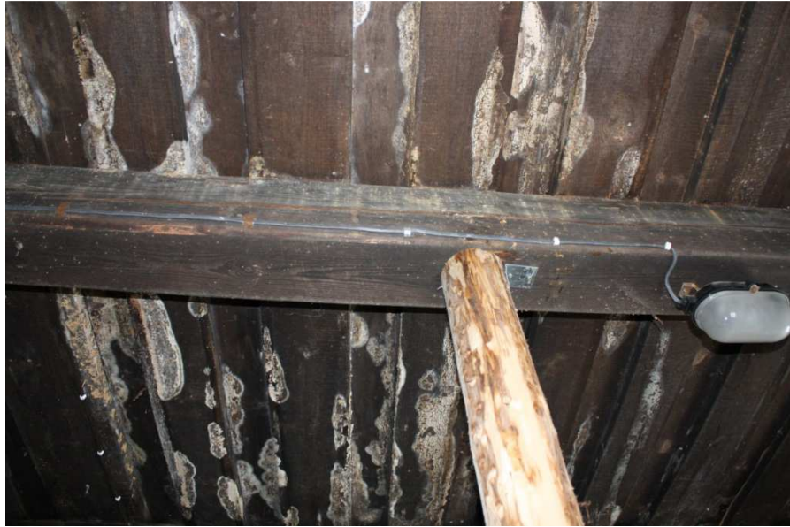
Foto 22. Seenkahjustus laelaudadel ruumis 5 ja laetala toetav turvapost. Autori foto.
