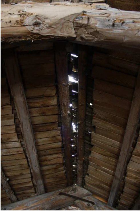
Foto 36. Puuduv harjaplekk; Veekahjustus. Autori foto.
