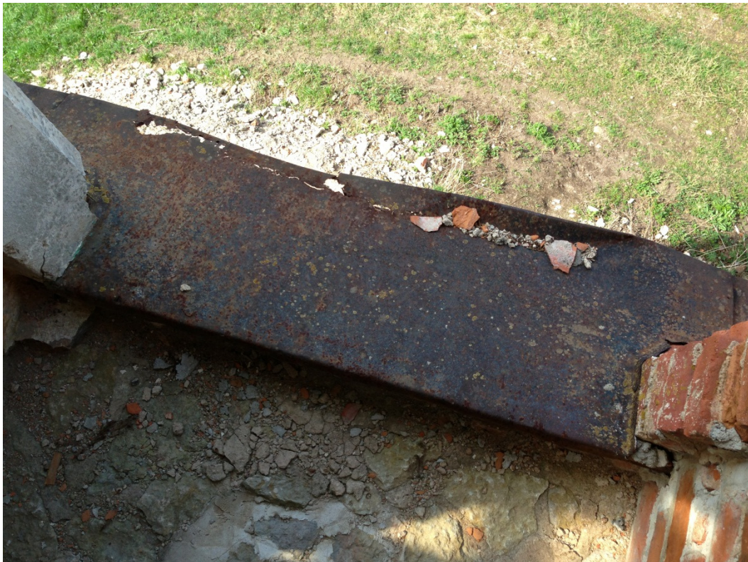
26. Kellaruumi kolmikakna veeplekk
