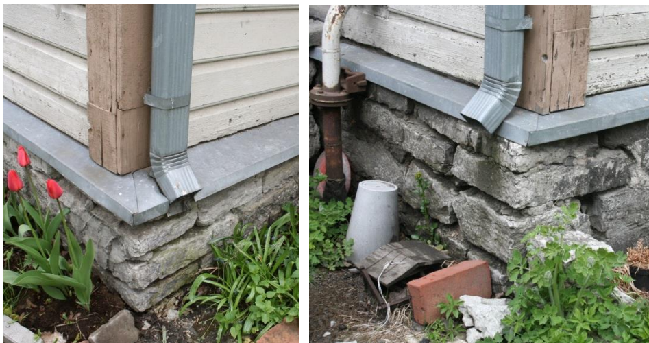
(Pilt16; 17) Uhutud vuukidega sokkel ja valesti paigaldatud sadevee torud (autori foto)
