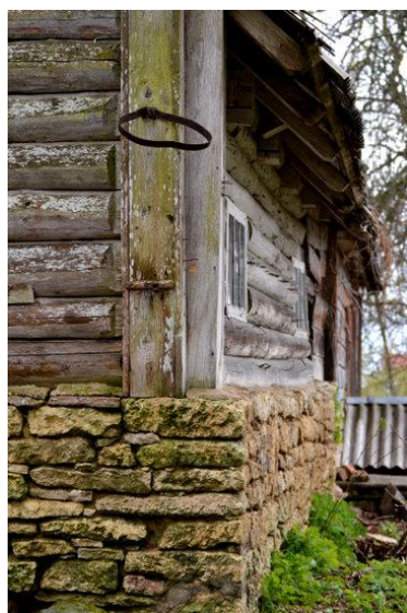
17. Puuduv sadevee ärajuhtimise süsteem
