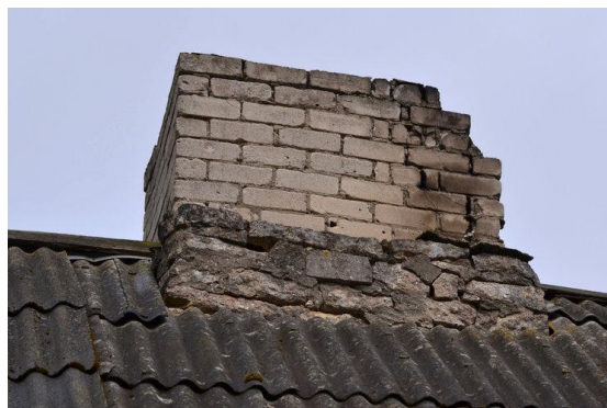
15. Avariiline korstnapits, vaade läänest
