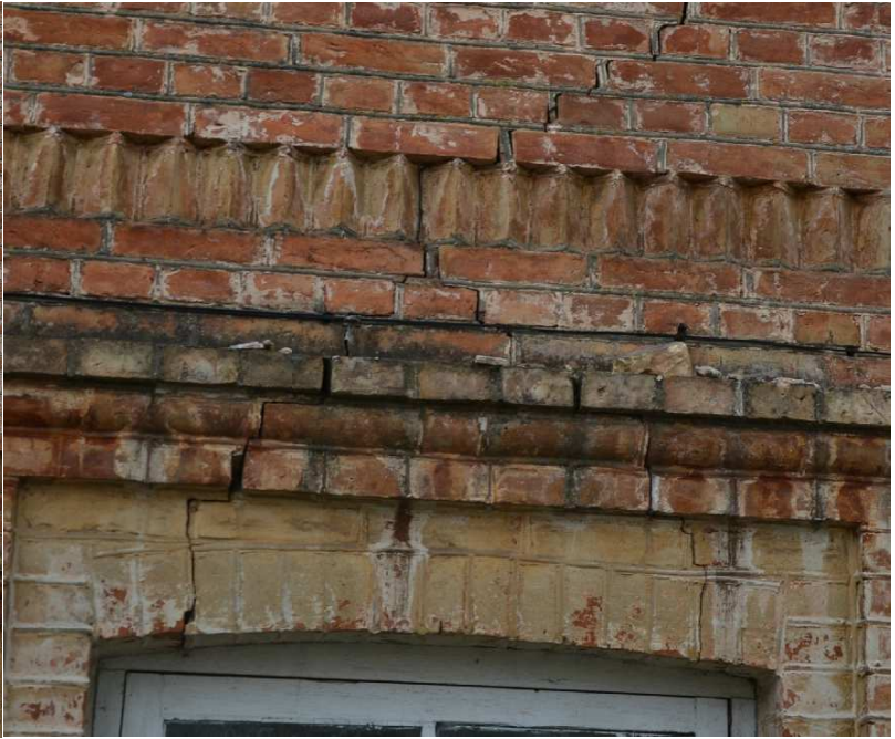
Foto nr 14. Mõrad hoone kagunurgas.
