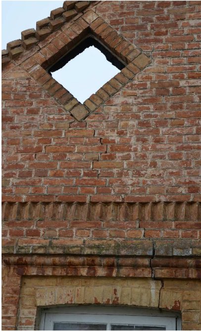
Foto nr 13. Mõrad hoone kirdenurgas.
