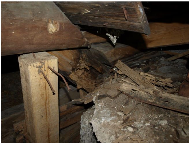
6. Foto 5. Puidukahjurid katusekandmikul.
