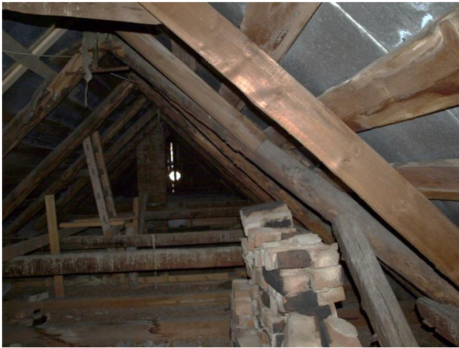
5. Foto 4. Pööningul on näha endise antenni asukoht ja vee kashjustus selle all.
