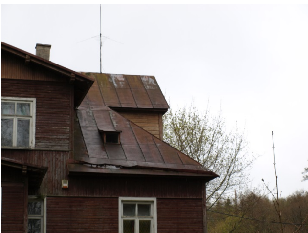
7. Foto 6. Kahjustunud vihmavee süsteem.
