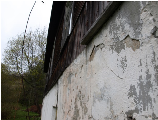
11.Foto 10.Sokli kahjustused ja puuduv veelaud
