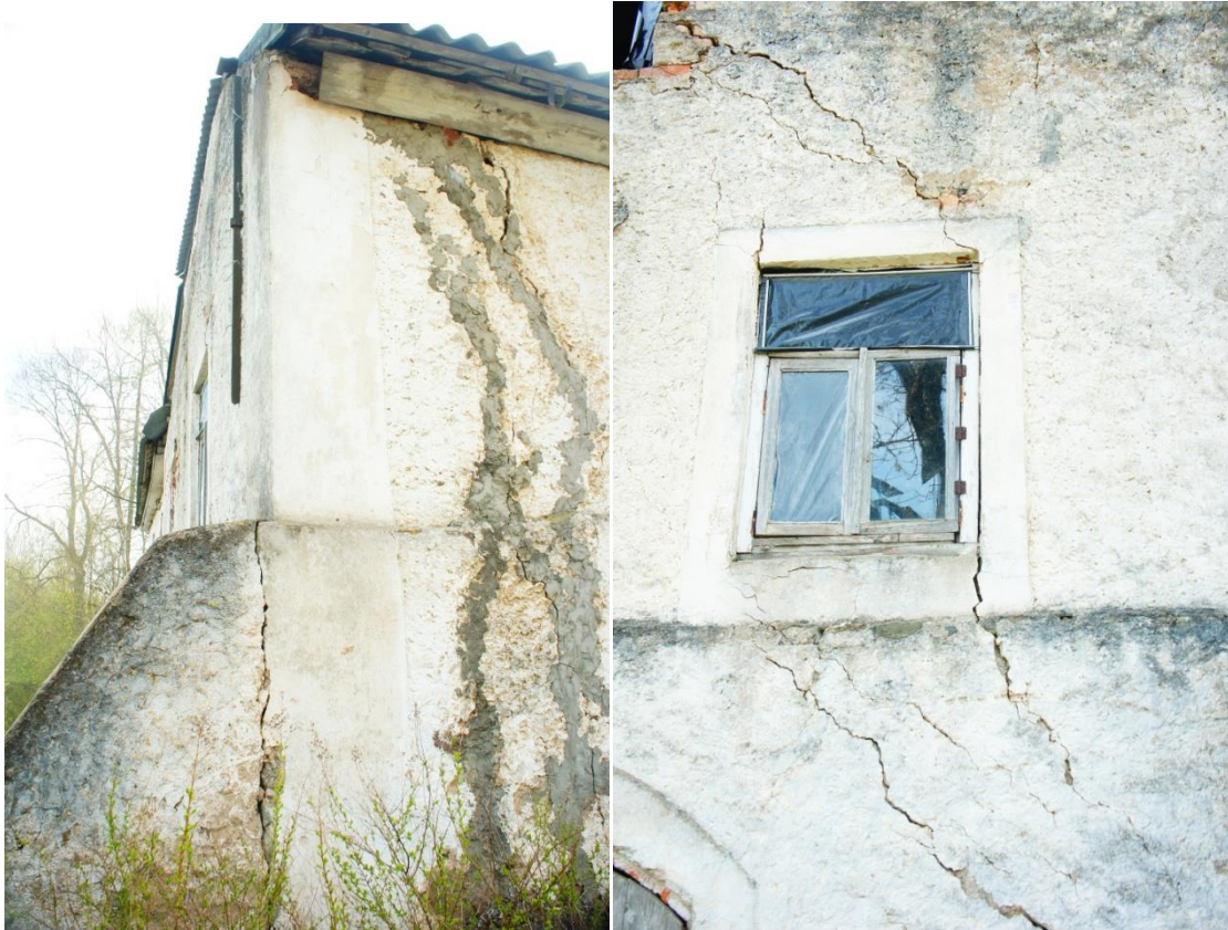
Foto 20 Külgseina suur pragu, näha ka pikitõmb ja katuseserva puudulik katmine
