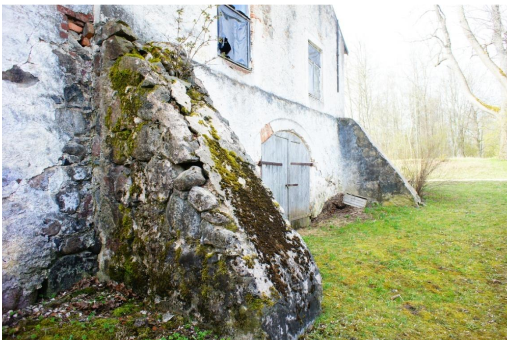
Foto 17 Põhiosa põhjapoolse sokliosia on toetatud kahe tugiseinaga, mis võivad olla rajatud vahetult peale hoone ehitamist. Tugiseinte vahelt on näha kahepoolne keldriuks.
