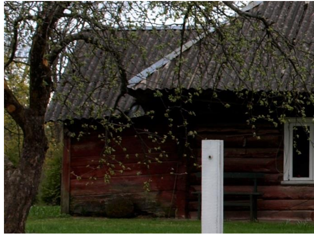
Il.12. Seina lagunemine katuselt tuleva vihmavee tõttu.
