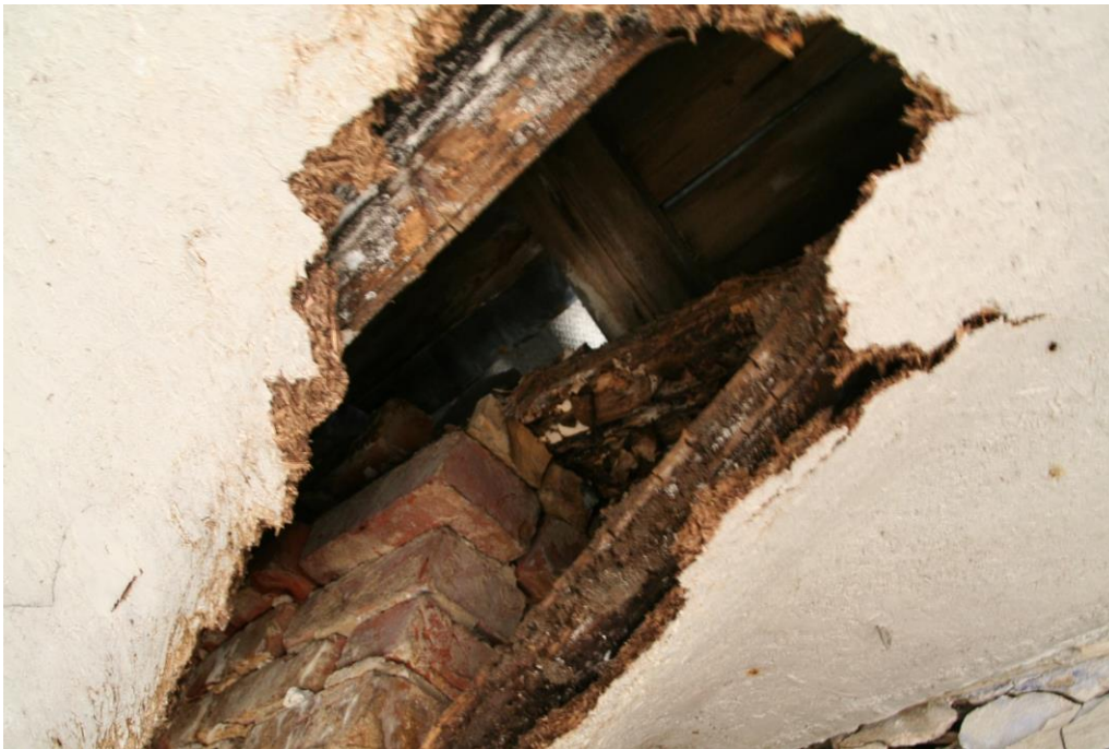
III 29. Korstnaümbruse katusekonstruktsiooni niiskuskahjustus II korrusel.
