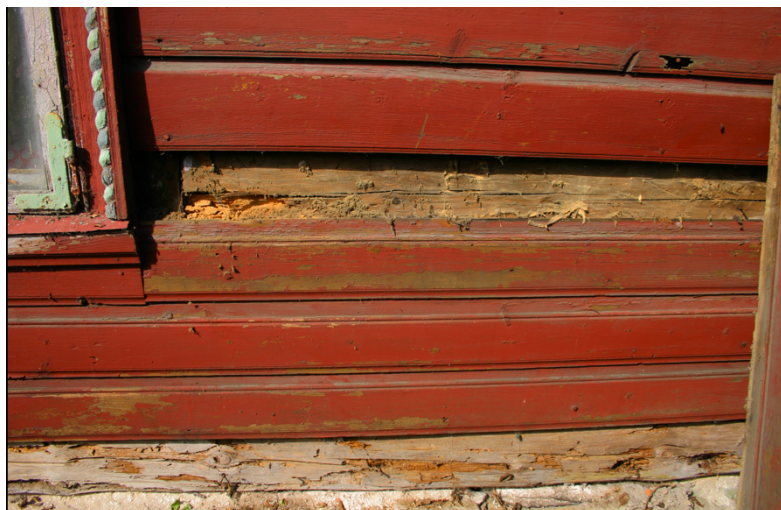
57. Putukkahjustustega palk hoone kaguküljel.
