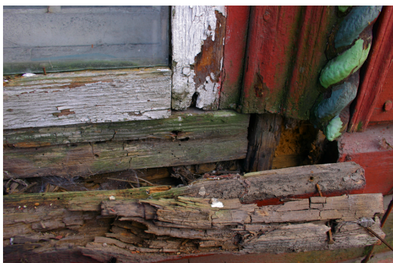
56. Akna ümbruse kahjustused hoone esiküljel.
