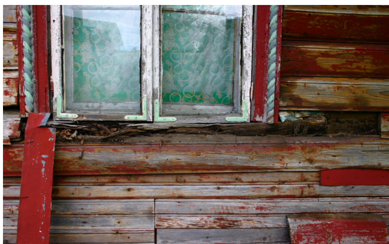
55. Hoone esikülje akna ümbruse kahjustused.
