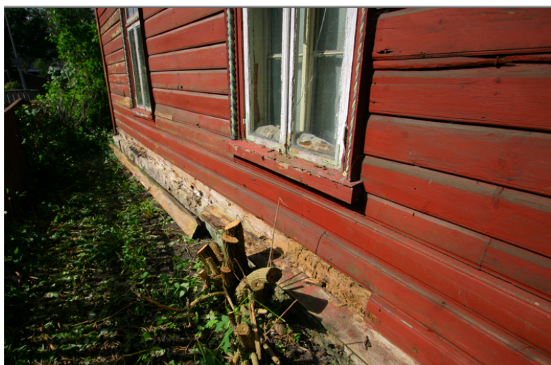
54. Kahjustused hoone kagukülje alumisel palgil.
