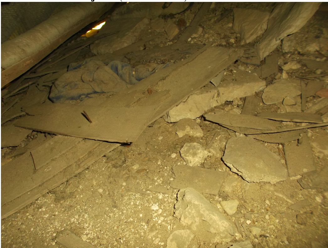
Joonis 21. Paemüüridel leidunud puitlaastud annavad aimu varasemast katusekatte materjalist (autori foto 2014)
