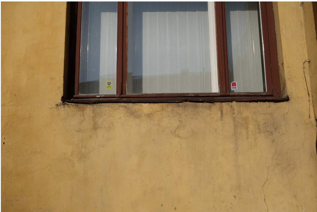
Pilt nr 13. Vaade katusepealsele rennile ja aegu näinud akna veeplekile. Allikas: A-L.Lindeberg, aprill 2014.
