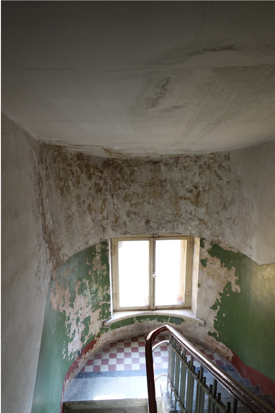
Pilt nr 11. Vaade niiskuskahjustustele trepikojas. Allikas: A-L.Lindeberg, aprill 2014
