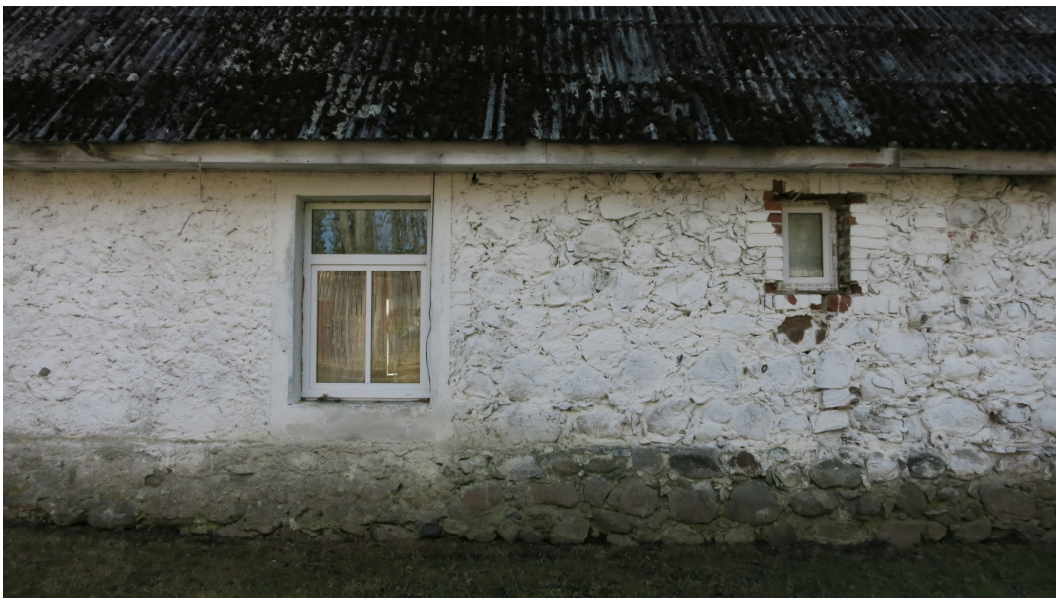
Foto 44. Vaade välisseina erinevusele ja akendele hoone kirdefassaadil (2014)
