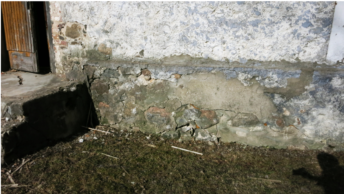
Foto 13. Kinnilaotud avaus korteri nr 3 sissepääsu kõrval vundamendis (2013)
