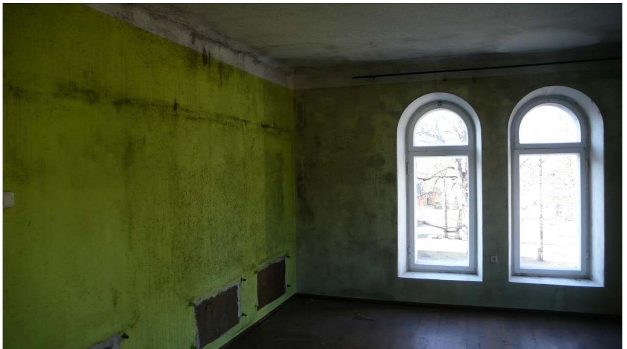
17. Esiküljel asuva torni seintele ja laele on tekkinud hallitus (teine korrus, aprill 2014).
