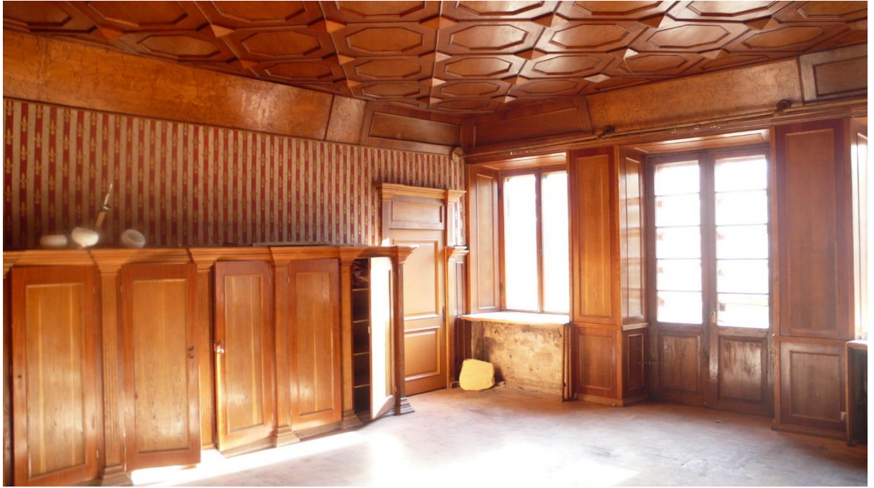
10. Söögisaal. Lume sulamisel võib vesi tungida välisukse alt sisse kuna välisterrass on katmata ja samas tasapinnas siseruumiga.
