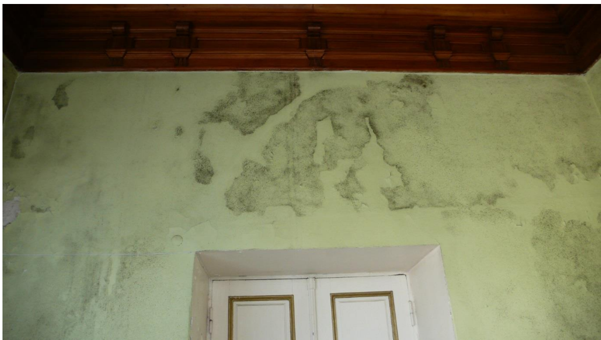
18. Hallitus on tekkinud ka torni all olevasse ruumi.
