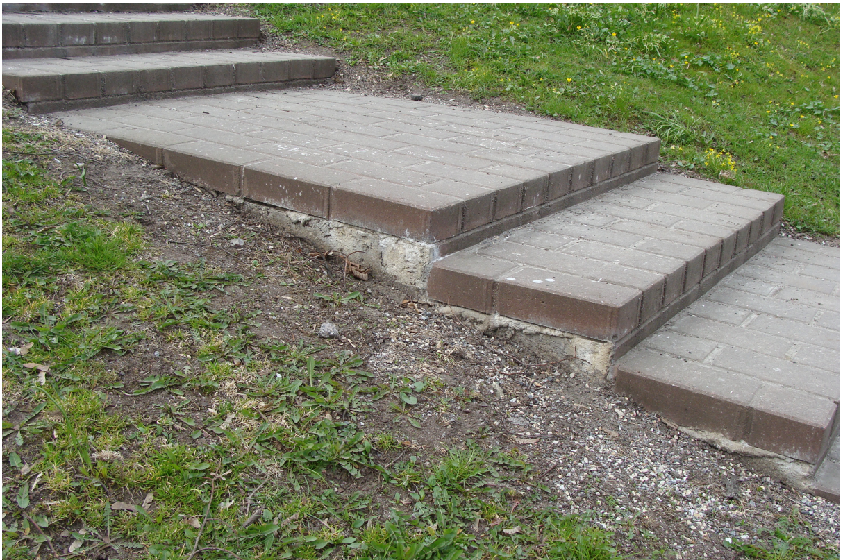
Foto 43 Vabaduse samba taga paljandunud trepi konstruktsioon
