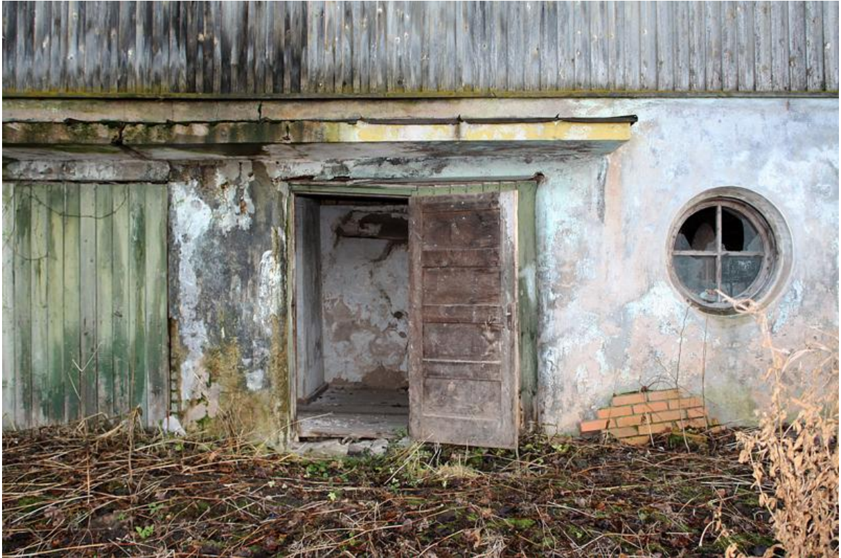
Ill. 12. Maja lääneseina sissepääsud soklikorrusele. Ustel kohal paikneb lihtsakoeline, ent stiili järgiv betoonist varikatus/räästas. Nii varikatusel, kui kõikjal soklil on täheldatavad ulatuslikud kahjustused.
