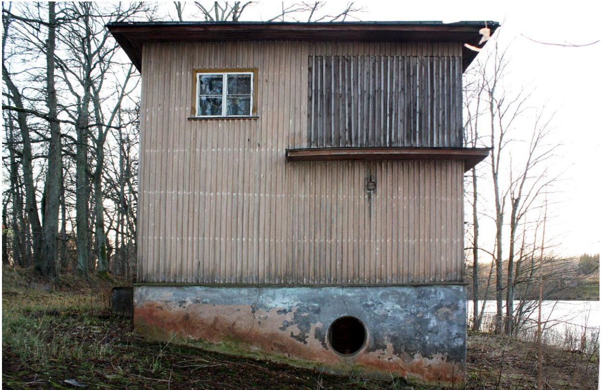
Ill. 2. Hoone põhjasein. Ümarakna raam on eemaldatud, soklil ulatuslikud biokahjustused.
