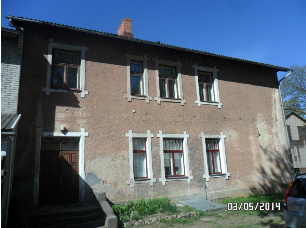
Foto 4. Sisehoovi fassaadi kahjustused: vihmaveetoru juures välisnurgas ja välisukse kõrval
