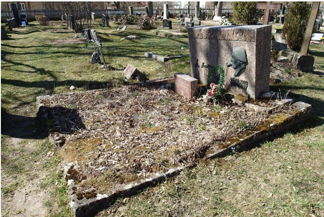
F50. Hauaplatsi vajumised, vaade põhjast
