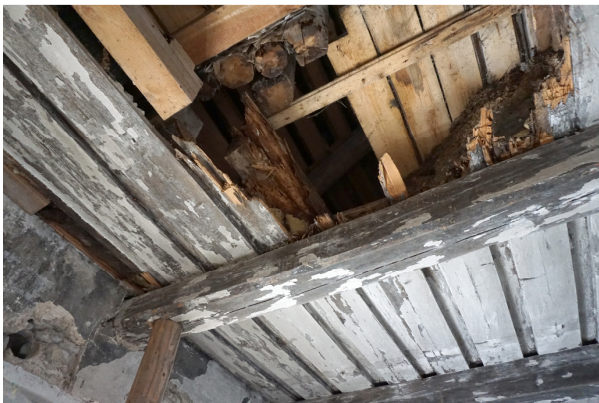
Illustratsioon 44 – Kahjustus ruumis 02
