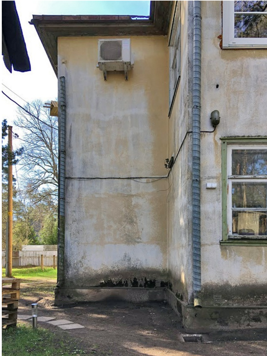
Illustratsioon 13. Hoone NE-nurk. Sokkel ja fassaad tugevate niiskuskahjustustega, porine ja sammaldunud. Seda põhjustavad läbiroostetanud ja lekkiv katuserenn, purunenud sadeveectoru, õhksoojuspumba agregaat, millest tilgub töötades vett ning ebasobivad kalded hoone perimeetris. Näha on ka II korruse tuulekasti külge kinnitatud massivne linnumaja, juhtmed, isolaatorid, augud fassaadil.
