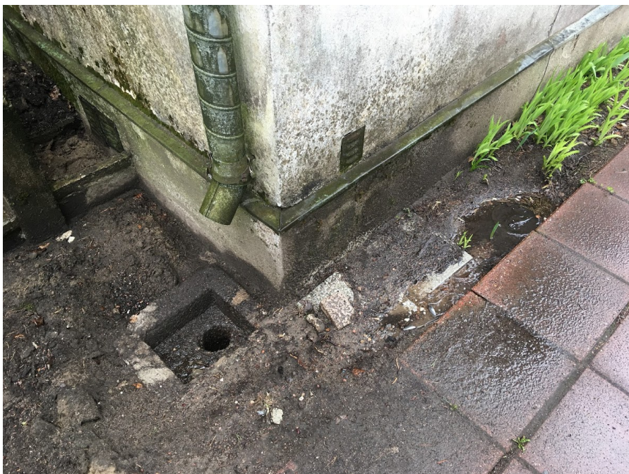
Illustratsioon 12. Hoone põhimahu NW-nurk hiljuti väljakaevatud trapi, sokli ja fassaadi niiskuskahjustuste ja sambla, valesti paigaldatud sillutise tõttu lõksu jäänud sadevee ja sokli ääres kasvavae taimedega.
