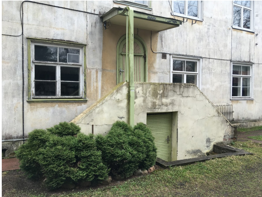
Illustratsioon 20: VK3 katus keti, renni, posti ja veetoruga, piirde krohv mõradega ja varisenud. Fassaadil kaablid, ventilatsiooniavad jm. Taim liiga lähedal.
