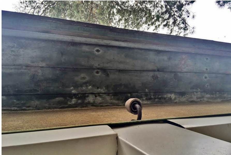
Illustratsioon 22: Katuse tuulekast on kogu perimeetris lihtne, kolme laua laiune ja linaõlivärviga kaetud.
