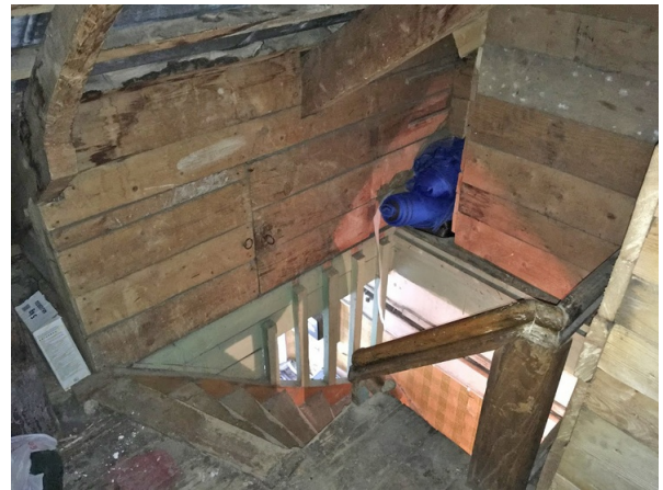
Illustratsioon 219: ST2 pööningult, roheka piirde kohal viilualused panipaigad.
