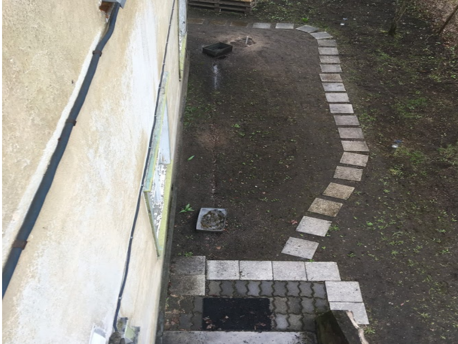
Illustratsioon 7. Vaade E-külje hoovile eklektilise sillutise ja sadeveesüsteemi avariilisusest tingitud pinnasekahjustustega. Fassaadil kaks kaablit.
