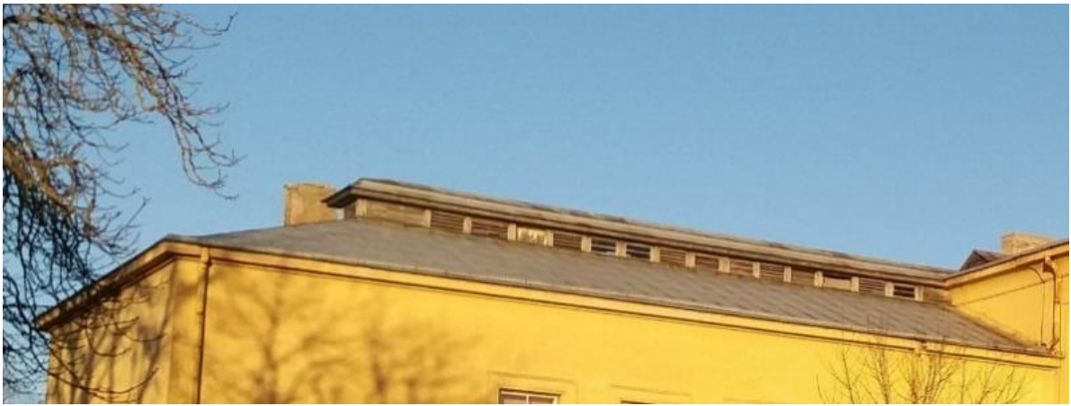
17. Õhukollektor W-tiiva katusel.
