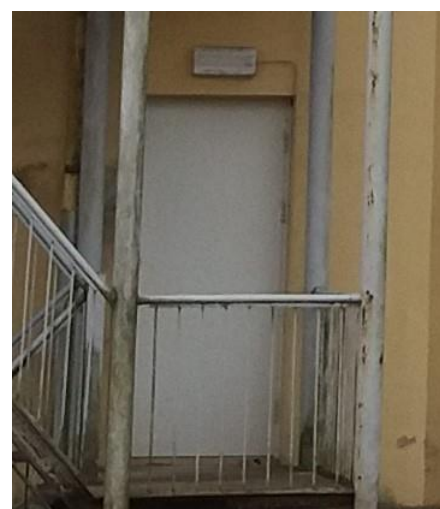
55. VU-5. Evakuatsioonitrepi uks.
