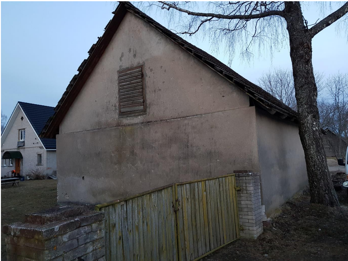
51. Aidahoone katuse on puulehtede kõdunemine liiga teinud
