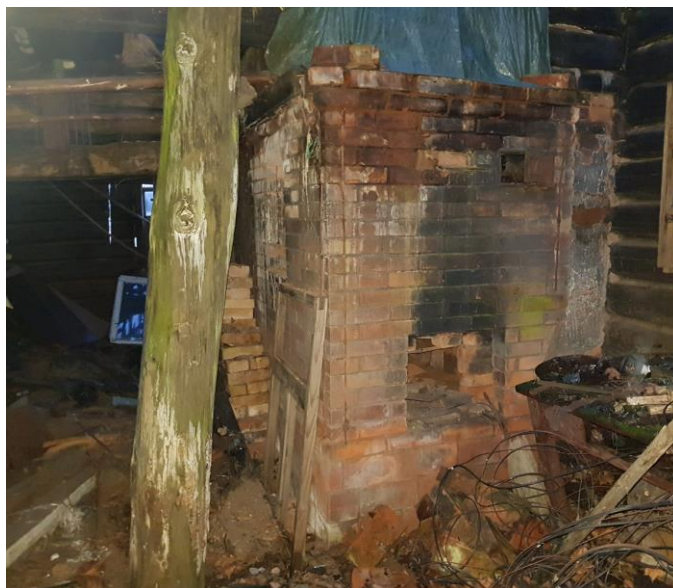
33. Eluhoones 2 asuv puukütteil ahi
