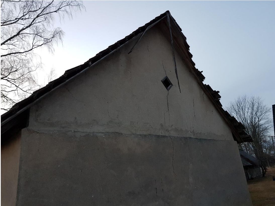
49. Aidahoone katuseräästas on vigastada saanud
