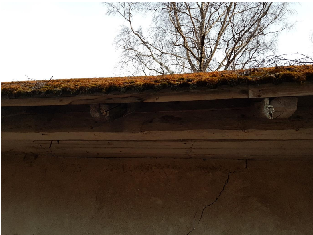
14. Aidahoone katusekivid on hävinud puulehtede kõdunemise tagajärjel
