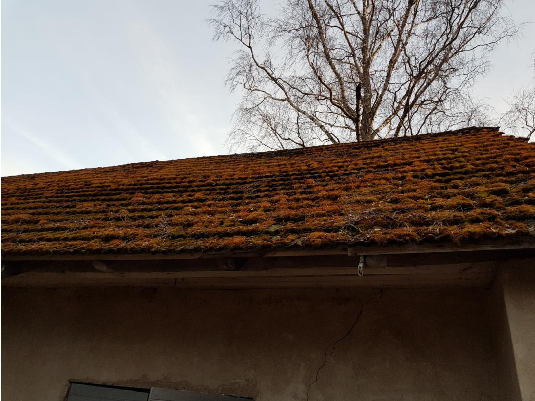
13. Aidahoone katusekivid on hävinud puulehtede kõdunemise tagajärjel
