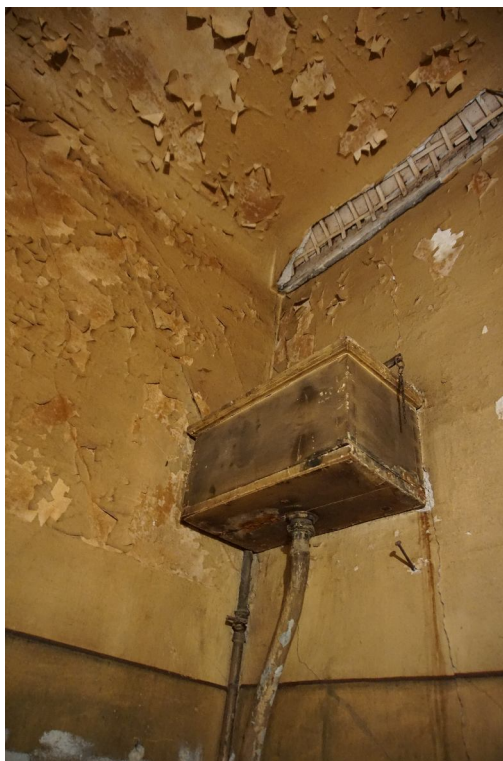
Foto 45. WC loputuskast vannitoas, ruum 58
