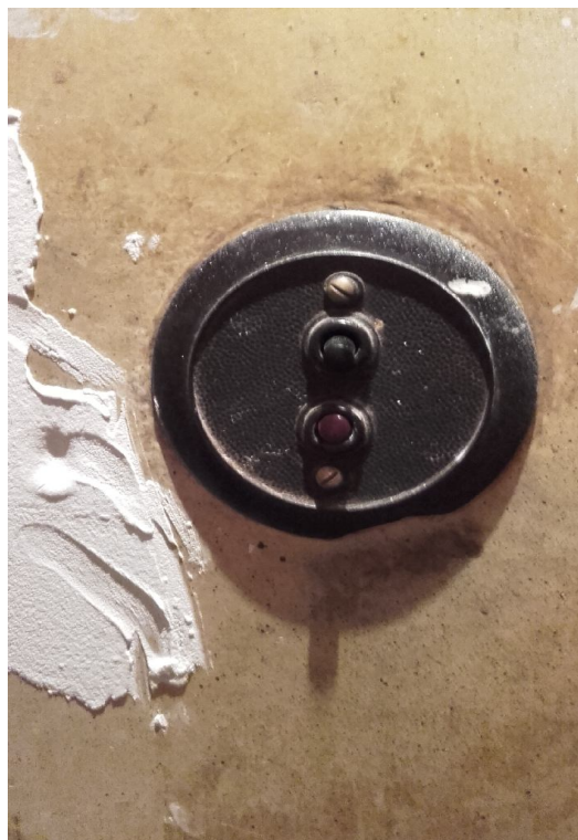
Foto 44. Elektrilüüti vannitoas, ruum 58
