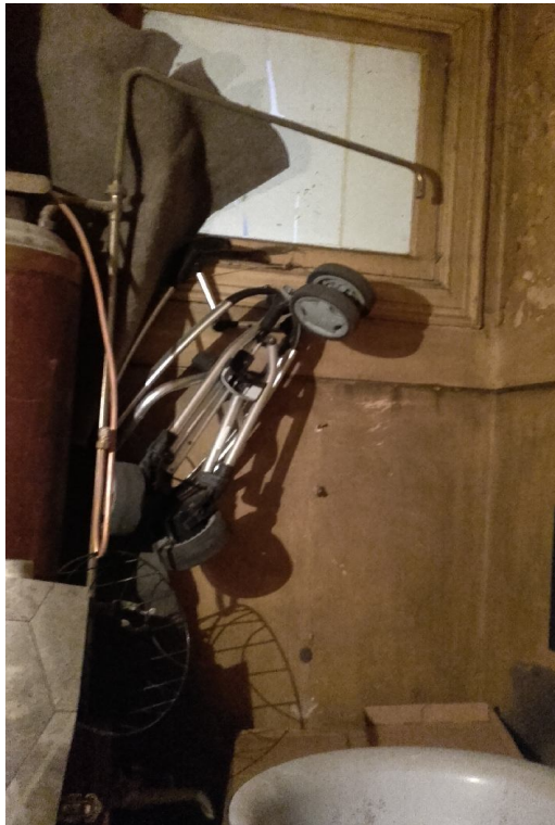
Foto 42. Vann ja kuumaveboiler vannitoas, ruum 58
