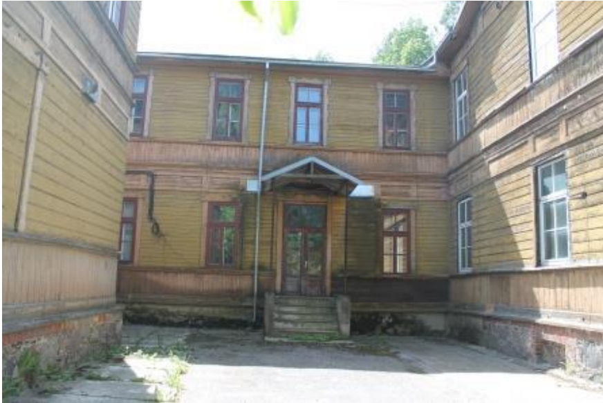
Foto 9. Hoone kõrvalsissepääs VU7. Näha algseid puidust aknaraame ja -piitu, uusi plastikraame, veekahjustusi laudisel ning fassaadi
