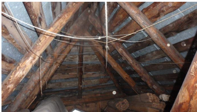
16. Katuse kandekonstruktsioon (autori foto 09.03.2018)
