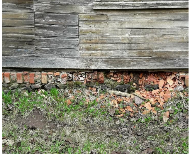
Foto 8. Sokli kahjustatud osa, autori foto
