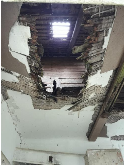
Foto 19. Eterniitplaadi puudumine katusel, autori foto
