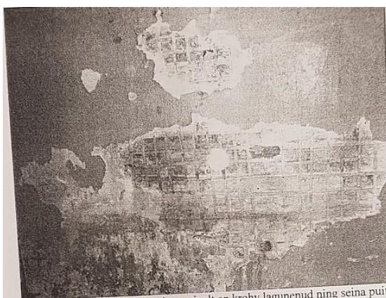
Foto nr.9. Korteris nr.11 vannitoa seinalt on krohv lagunened ning seina puitlaudis on kohati pehkinud.
