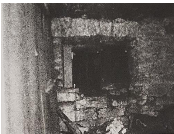
Foto nr.3. Keldri välissein. Keldri paekivist välisseina sisemine kiht on keldri akna juures lagunenu. Keldri akna kohal on paekivist lamevõlvilluses olevad paekivid allapoole vajunud ning sillus võib puruneda. Keldri aken on kaetud vineeriga.
