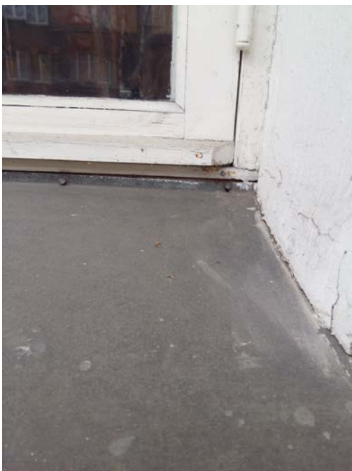
Fotod 62, 63 ja 64. Akna kahjustused. Autori foto.
