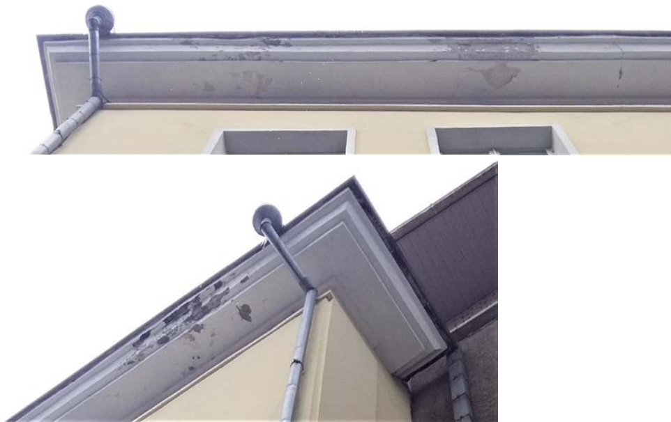
Fotod 43 ja 44. Karniisi kahjustused. Autori foto.
