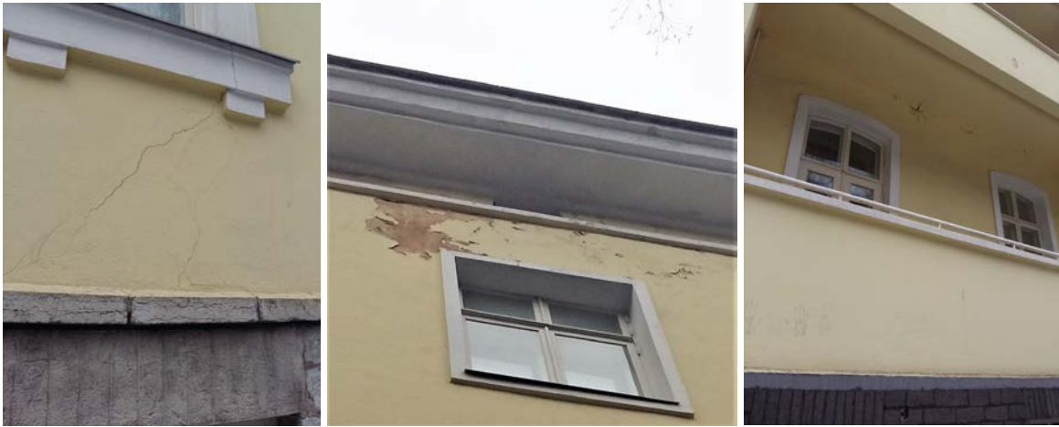
Fotod 37, 38 ja 39. Fassaadi välisviimistluse kahjustused. Autori foto.
