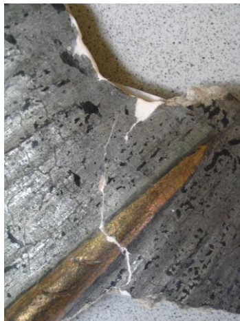
42. Vapikiivri detail pärast kahjustuse krundimist
