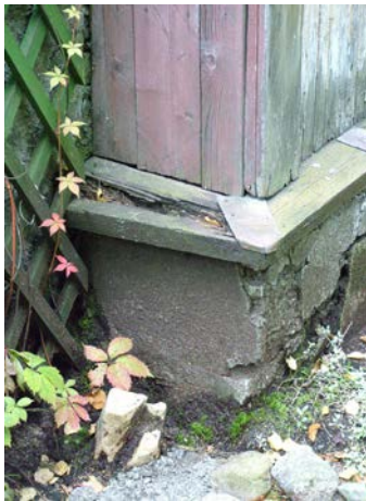
Ill. 9: Idaküljel on vundamenti katval krohvil külma- ja niiskuskahjustused. Foto: Sandra Mälk. Sügis 2008.
