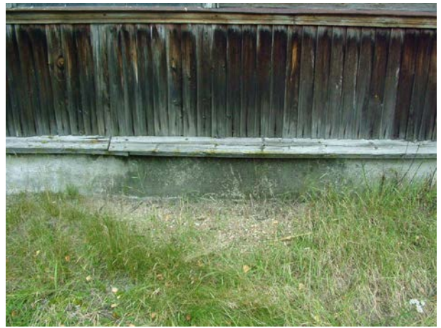
Ill. 10: Hoone lõunaküljel on vundamendis niiskuskahjustus. Foto: Sandra Mälk. Sügis 2008
