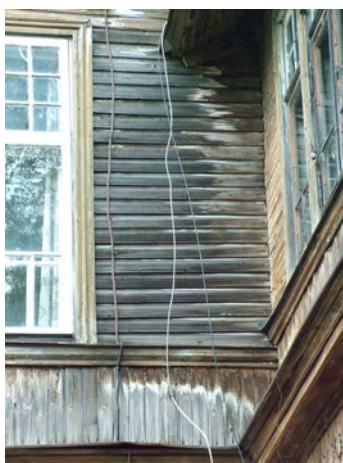
Ill. 12: Puudulikust sadevetesüsteemist põhjustatud kahjustused laudisel. Foto: Sandra Mälk. Sügis 2008.
