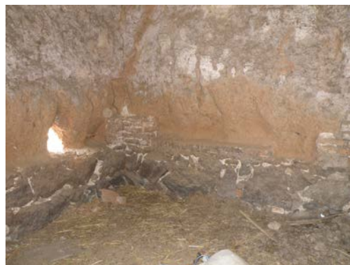
Foto 24: Sigade poolt tekitatud seinakahjustused
