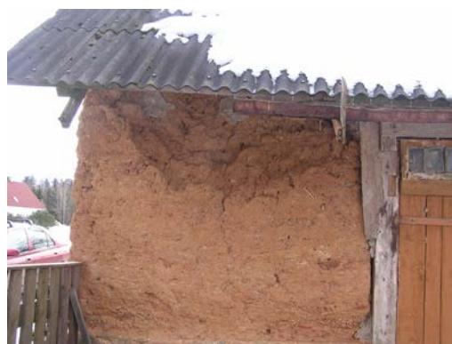
Foto 21: Liigniiskusest tekkinud erosioon
