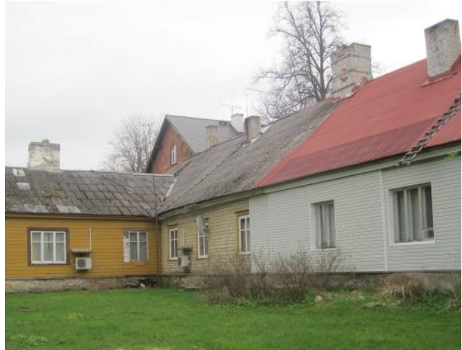
Loodi mõis; väljastpoolt soojustamise tulemusena tekivad puithoonel võõristust tekitavad aknapõsed.
