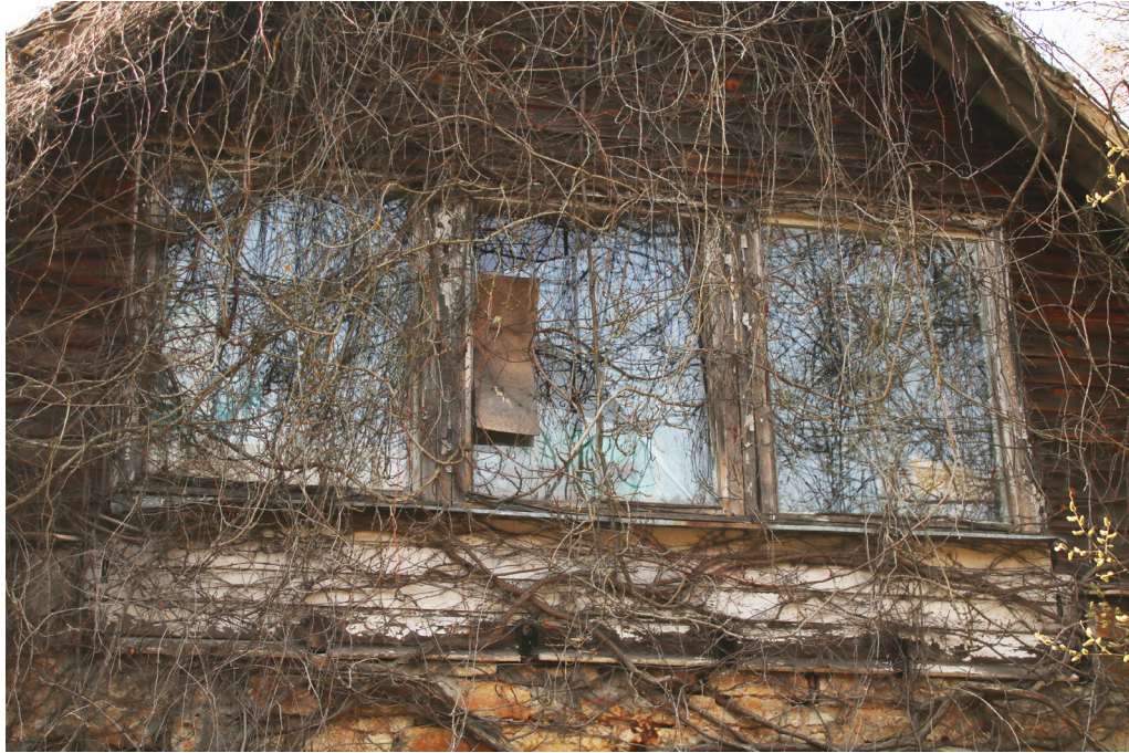
75. Vaade peahoone kaguotsa teise korruse aknale ning laudisele
