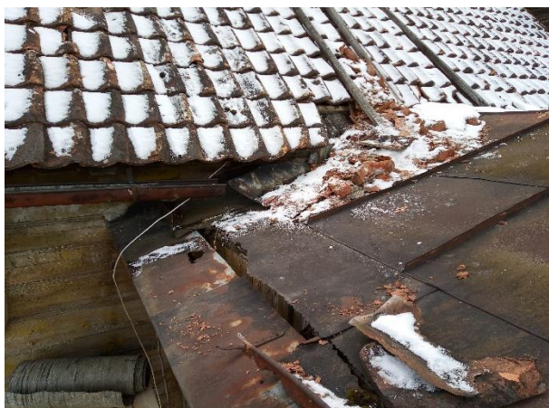
Foto 14. Avariiline veranda katus
