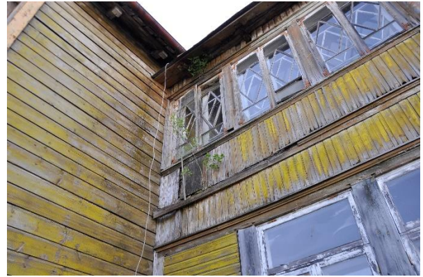
Foto 10. Kahjustunud veranda ja põhjafassaadi nurk
