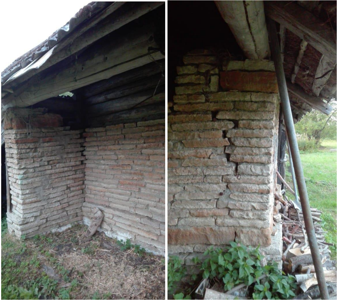
Joonis 71 ja Joonis 72 Vertikaalpraod müüritisel, tekkinud maapinna niiskusest ning katuse vajumisest
