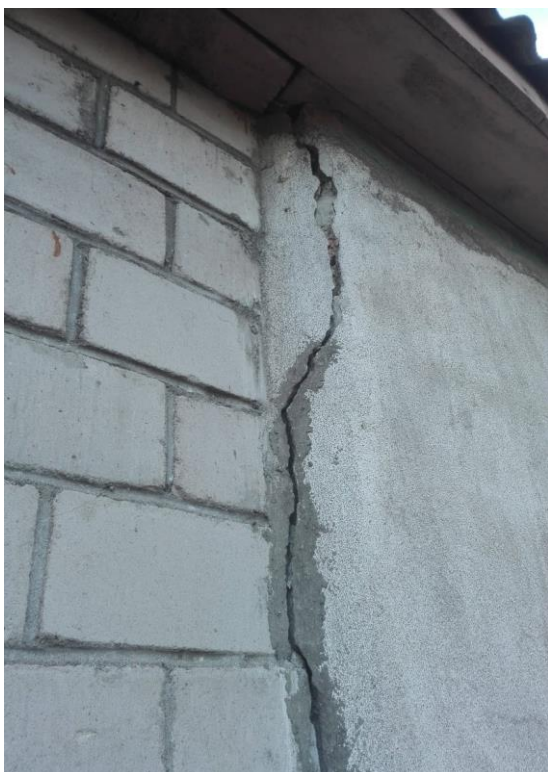
Joonis 47 vaade krohvikahjustusele tagaseinas
