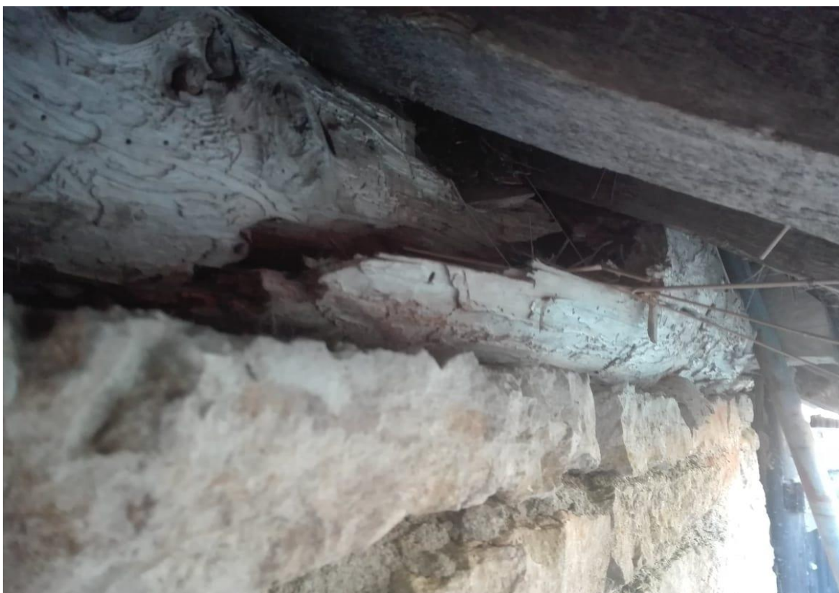
Joonis 66 Mädanikkahjustusega müürpalk esiseinas värava kohal
