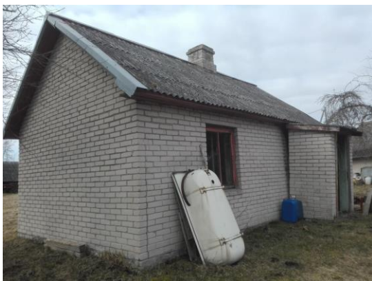
Joonis 13 Vaade saunale (nähtav vertikaalne deformatsioon otsa ja esisena ühenduskividel)
