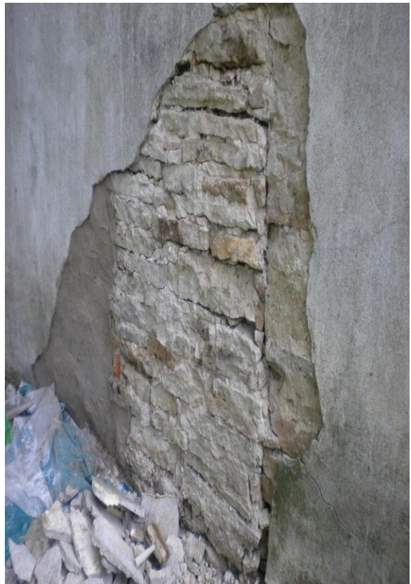
Joonis 46 Vaade ilmnunud uksekohale seinas
