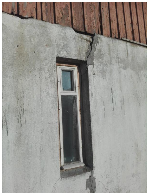
Joonis 48 Vaade kahjustusele sahvri akna ümber
