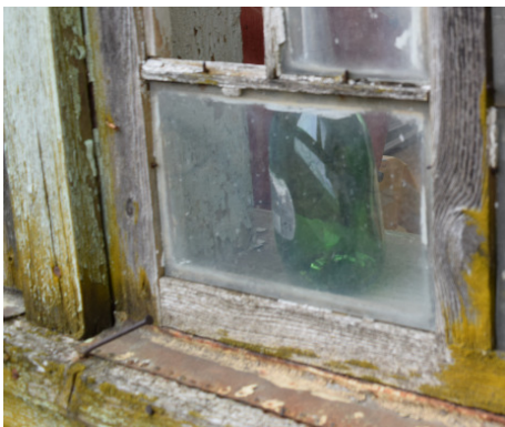
37. Kahjustunud piirdeliistud. Autori foto.
