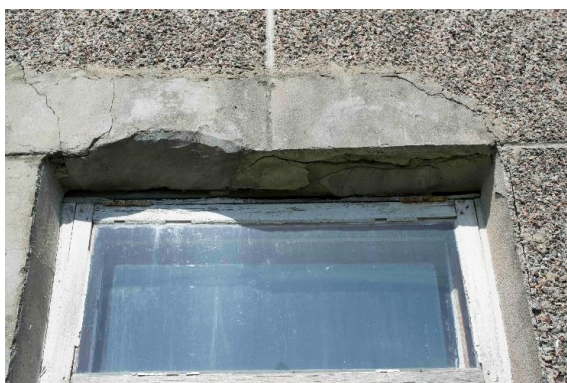
Foto 24. Kahjustus akna kohal
