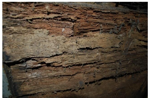
ill: 29. Tugev putukakahjustus vaheseinal. Foto 2008.
