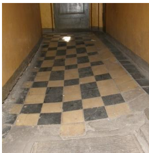
Foto 188. Võiduküla kooli malelauamustris põrandaplaadid. Hoone on vesise pinnase tõttu vajunud, trepikodades on vajumisjäljed. L. Välja, 2009.
